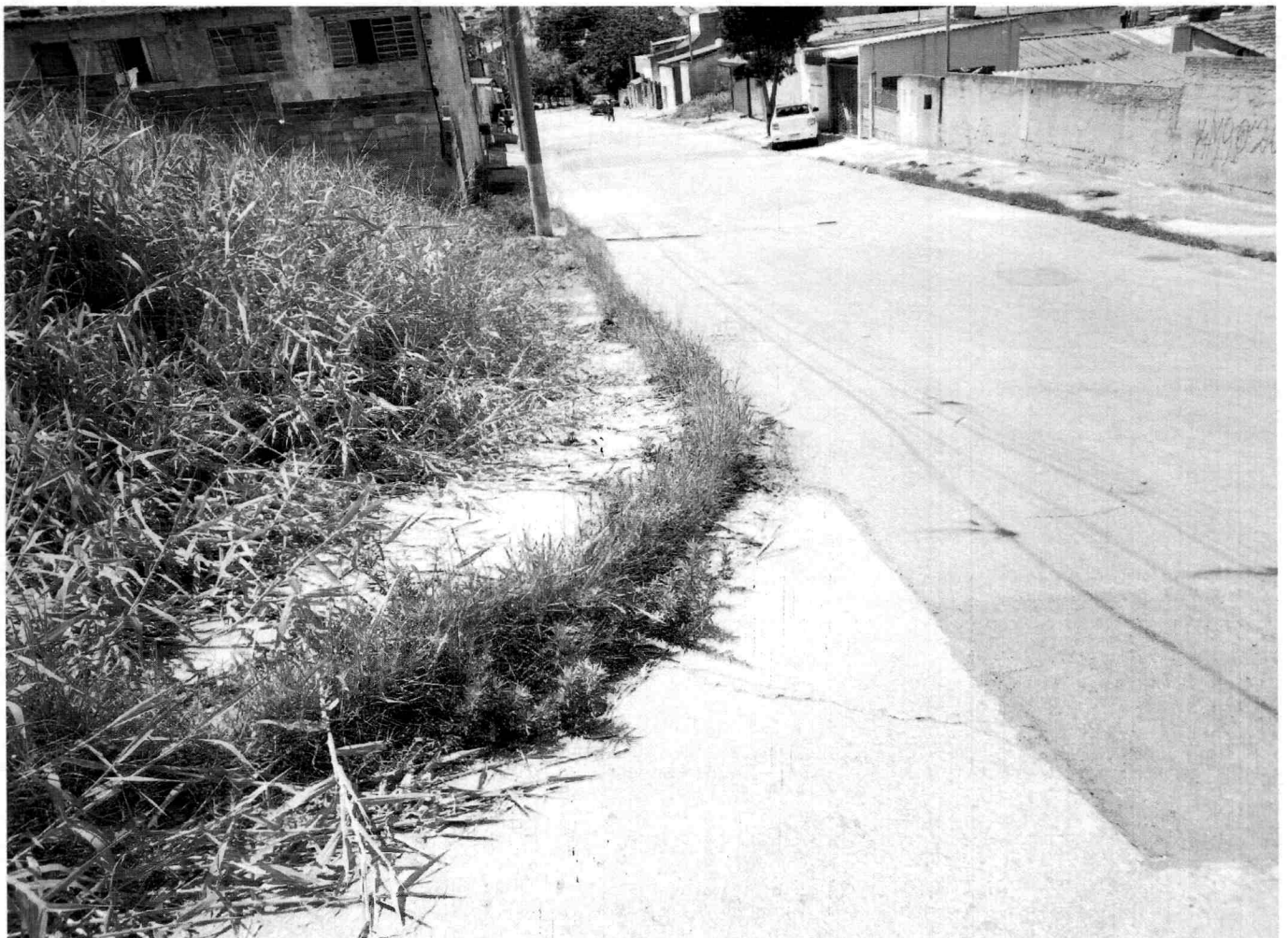
CAPINAÇÃO DE CABEÇAS DE GUIAS E RASPAGEM DE SARJETAS NO CRUZAMENTO DA RUA GASPAR VAZ COM A RUA PASTORA GORETE MORAIS, VILA CINTRA
